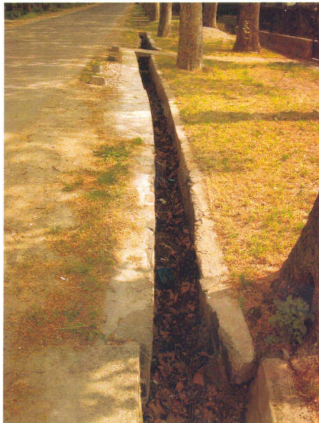
8. ábra A sugárút végén nem túl szerencsésen kialakított beton vízelvezető árok
